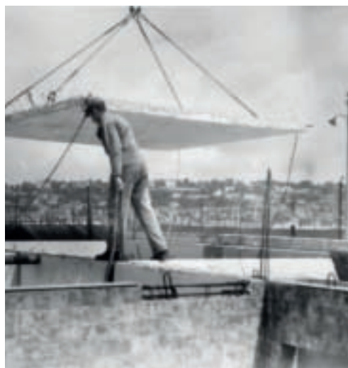
Pose d'un panneau « plafond-plancher » Camus sur le chantier de l'îlot N17, au Havre (AN/CAC/19771125/C3424).
