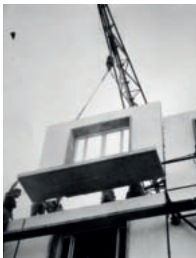
Pose d'un panneau de façade Camus équipé de sa dalle de balcon sur le chantier de l'îlot N17, au Havre (AN/CAC/19771125/C3424).
