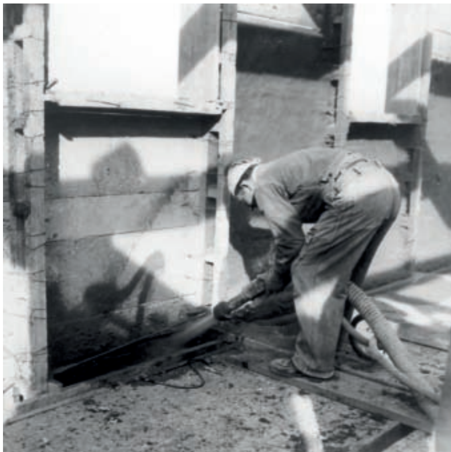
Projection de mortier au canon à ciment sur l'enveloppe extérieur d'un pavillon Inotro à la cité des Ruisselets, à Beauvais (Archives CSTB).
