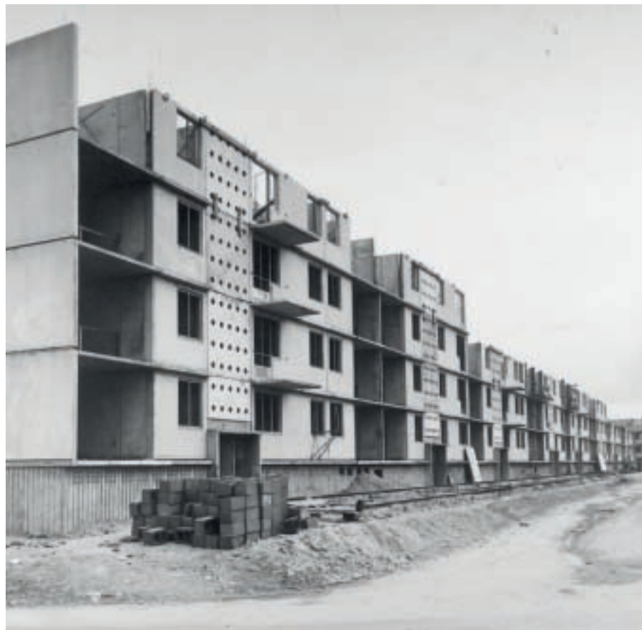
Chantier de l'opération de Nanterre réalisée dans le cadre des « 4000 logements de la Région parisienne » (Fonds Expositions du MRU/DAF/Cité de l'architecture et du patrimoine/Archives d'architecture du XX e siècle).
