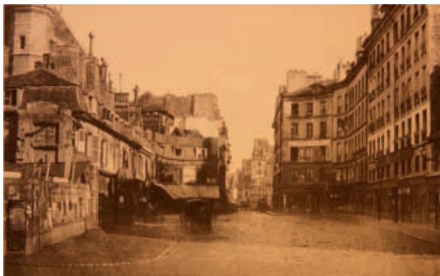
Travaux d'élargissement de la rue Réaumur, BHVP, photo de Ch. Marville [Marie de Thézy, Marville, Paris, Hazan, 1994, p. 392]
