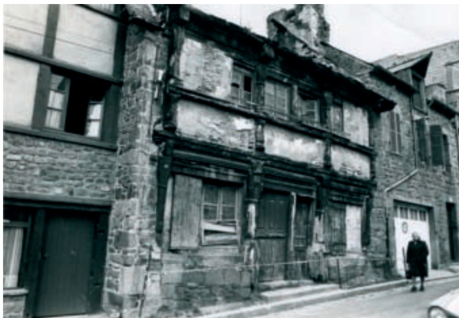
« Taudis » du centre, état de 1968 [AM Saint-Brieuc, 6 Fi 361]
