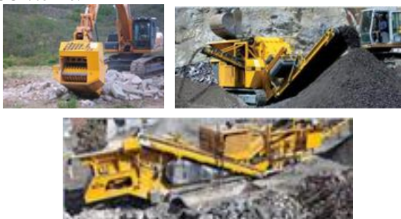
Fig. 2 : De haut en bas, concasseurs : petit, intermédiaire et important [10]
